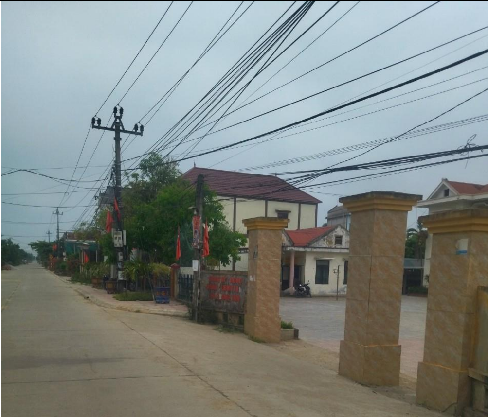
Hệ thống đường điện hiện trạng
